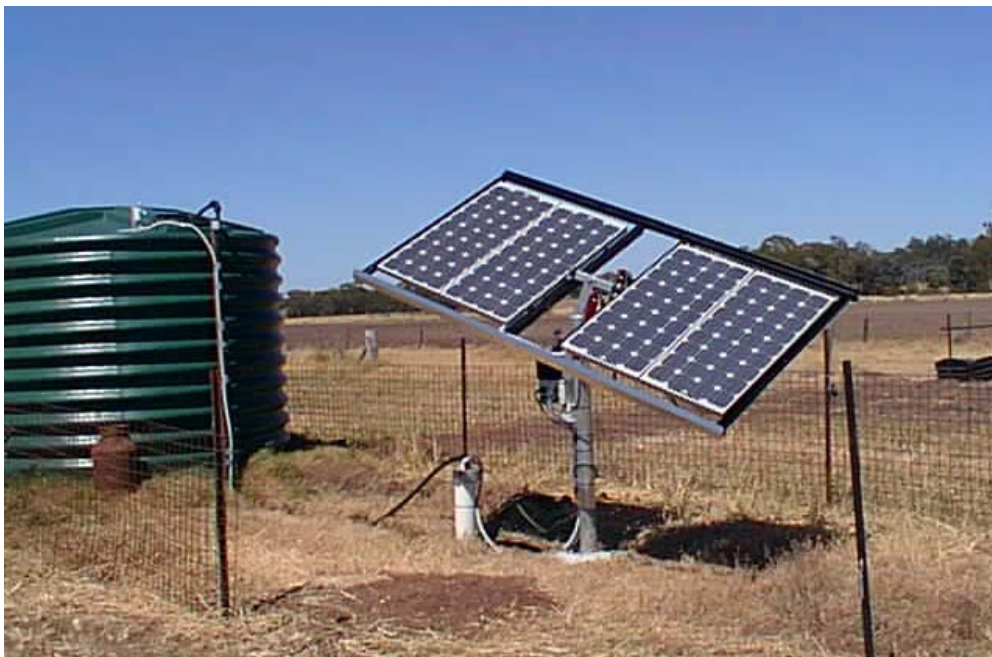
Photovoltaikpanel für Solarpumpen
